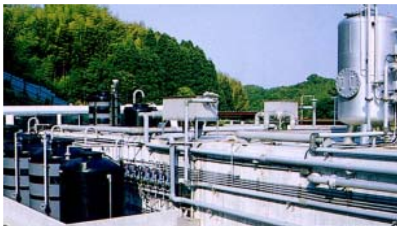
図 3-12 浸出水処理槽
