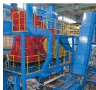
金属破碎・選別設備
